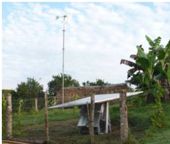
Figura 1 - Sistema híbrido (solar fotovoltaico-eólico) instalado en la escuela de la comunidad de Boca de Lurá, República de Panamá. Fuente: DELGADO et. al (2013)
