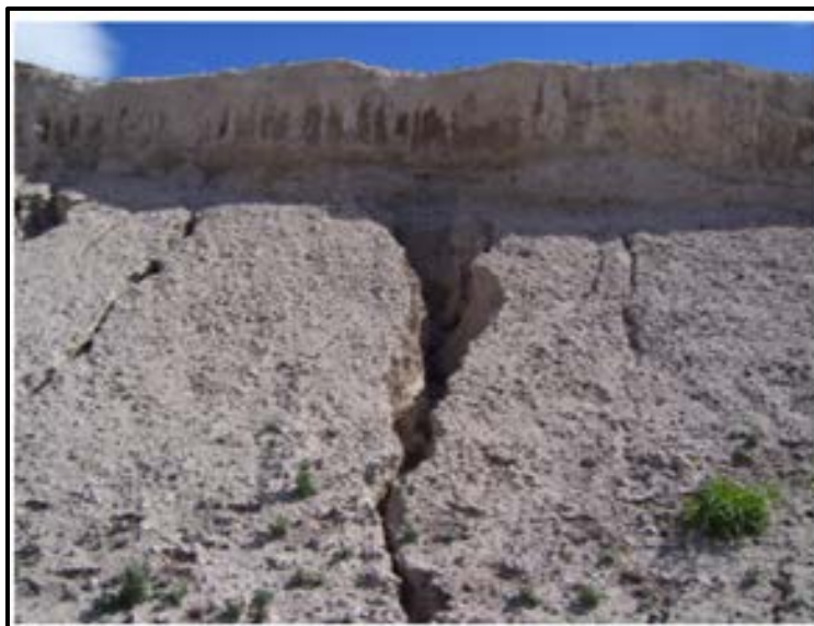
Figura 9. Taludes erosionados por el agua.
